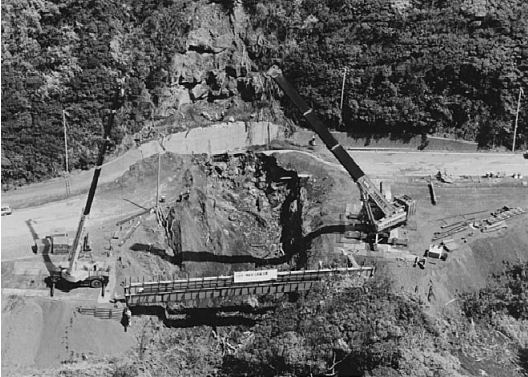
図3 平成13年5月13日 泥流と工事中の仮橋（立根）（資料：東京都）。
